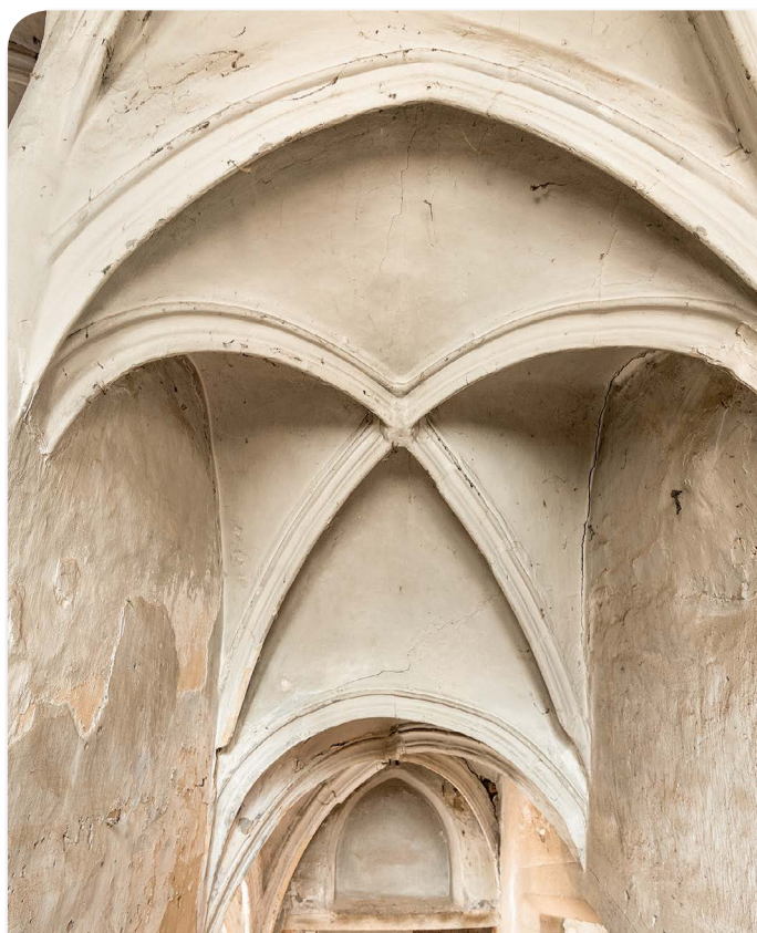
Mechelen. Hof van Palermo (15 de eeuw). Voormalige residentie van Jan II Carondelet, raadsheer van de Grote Raad van Mechelen. Project in uitvoering 2016.
